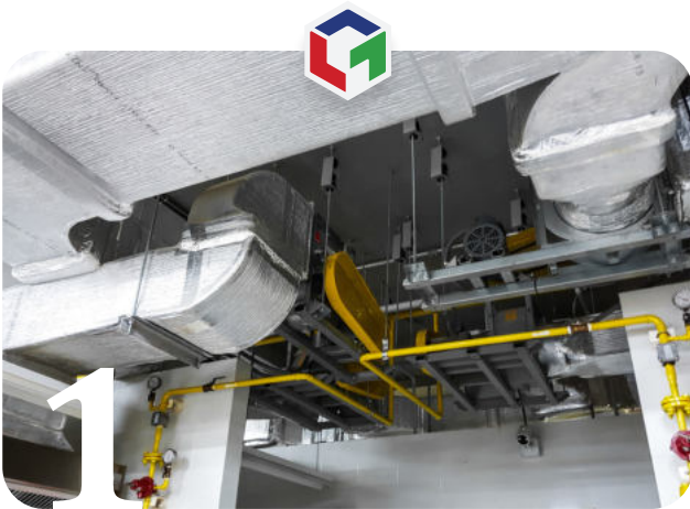
HỆ THỐNG HVAC
