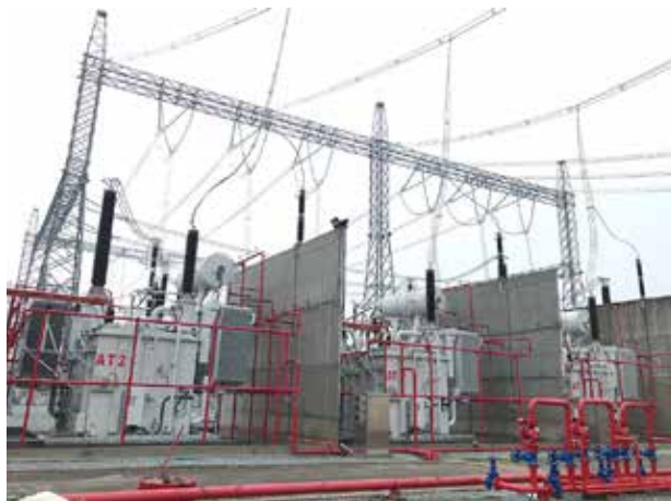
Trạm điện 500KV - Phú Lâm 500KV Power Station - Phu Lam
